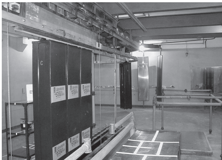
Fig. 7: Interior de la Cámara de Irradiación, Planta de Irradiación Semiindustrial de Cobalto 60, Centro Atómico Ezeiza, provincia de Buenos Aires, Argentina. (Cortesía Ing. Jorge Graiño).
