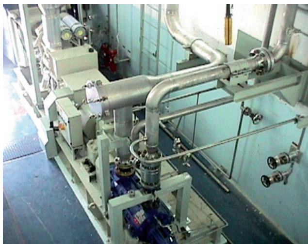
Figura 11. Segundo sumidero de calor Atucha 1.
