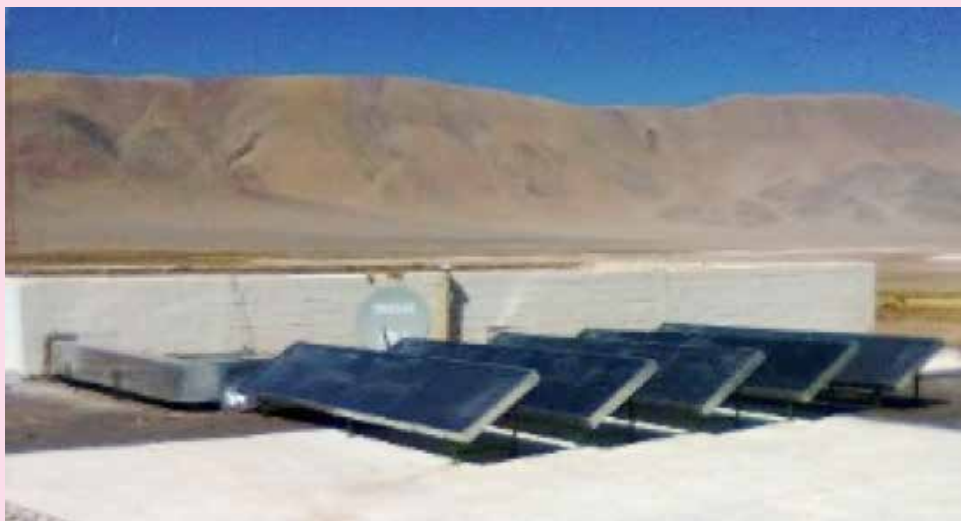
Figura 3: Calentadores solares instalados por INENCO en la comunidad de Tolar Grande, Salta.
