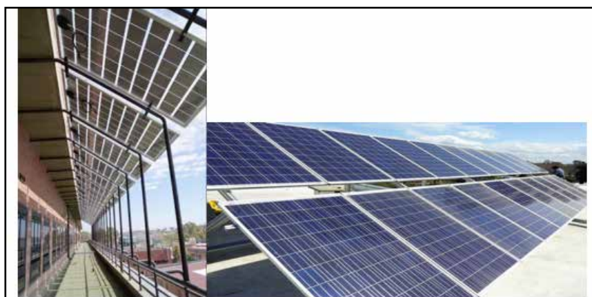
Figura 10: Sistemas FV instalados en el edificio TANDAR (CAC): (i) pérgola FV con 23 módulos de 215 W p , ubicada en el tercer piso del edificio (izquierda); (ii) 20 módulos FV de 240 W p , ubicados en la terraza (derecha).
