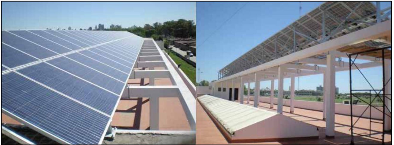
Figura 11: Pérgola FV de 17 kW p en la Facultad de Informática de la UNLP.
