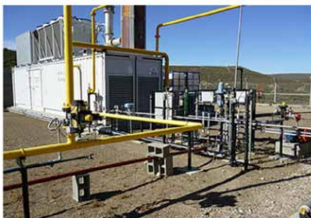
Figura 20: Motogenerador Jenbacher - GE, 1415 Kwatt. Funciona con mezclas gas natural + hidrógeno.
