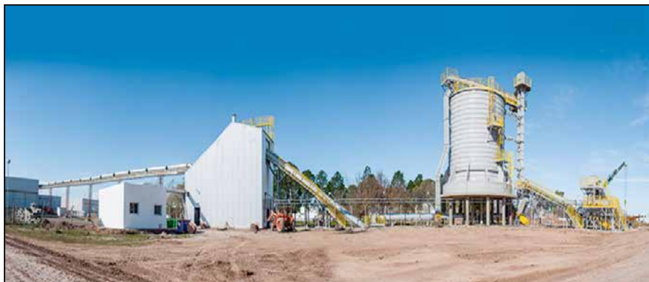
Ilustración 5. Silo de biomasa (derecha) y gasificador (centro).
