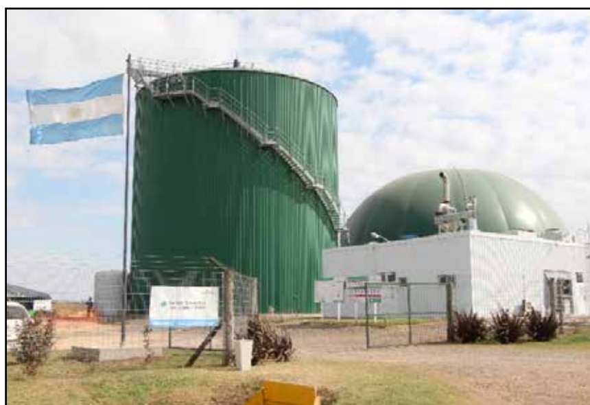
Ilustración 1. Vistas del digestor primario (izq.) y del digestor secundario(der.).
