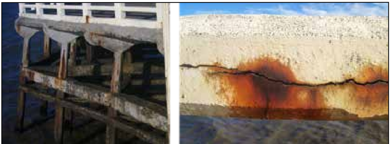
Figura 5. Corrosión de las barras de refuerzo en el hormigón armado debido a la presencia de cloruro. Las imágenes corresponden a estructuras en contacto con agua de mar. (izquierda: muelle que muestra la presencia de manchas sobre la superficie del hormigón; derecha: fisuración causada debido a la formación de productos de corrosión del hierro).
