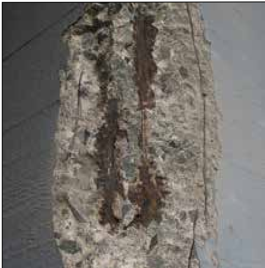
Figura 8. Delaminación del recubrimiento de hormigón debido a la presión generada por los productos de corrosión de las armaduras.
