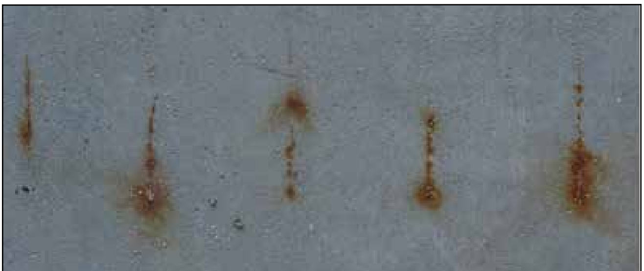
Figura 7. Manchas de óxido a lo largo de las barras de refuerzo en una estructura de hormigón armado.
