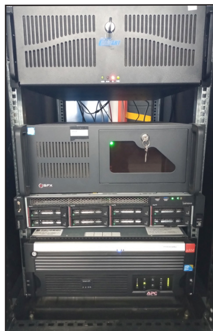
Figura 11. Unidades de almacenamiento de memoria en la sala del IAR
